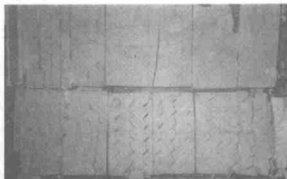
图4 模型试件 I 单压破坏情况
